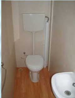
WC s hornou nádržou na vodu
